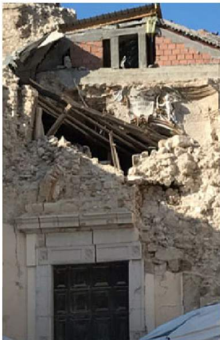
Telaio in c.a che ha martellato su chiesa
